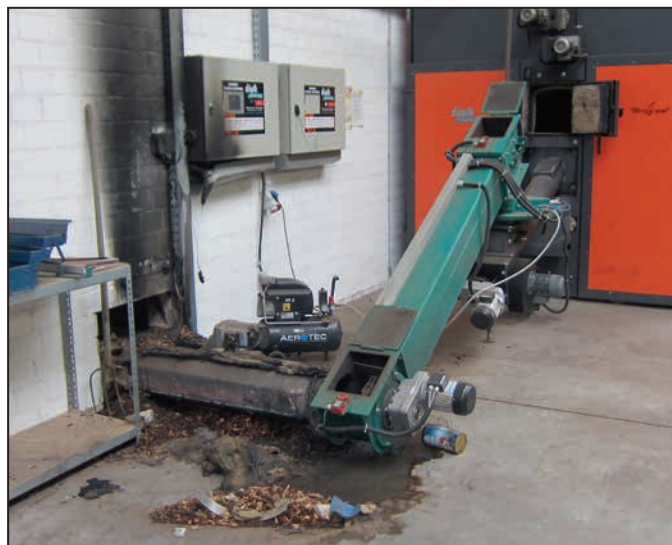
Photo 7 : Retour de flamme du silo à combustible vers le convoyeur de combustible
